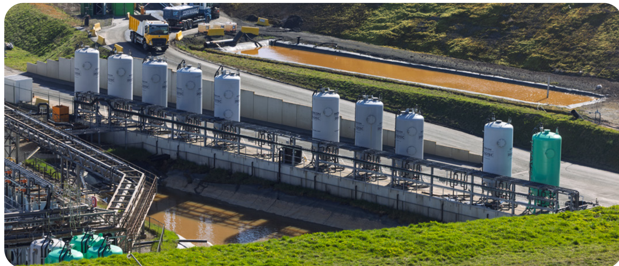
Een uitgebreide waterzuiveringsinstallatie met actief koolfilters zorgt ervoor dat geen korte of lange ketens PFAS meer gedetecteerd worden in het afvalwater van Indaver.
